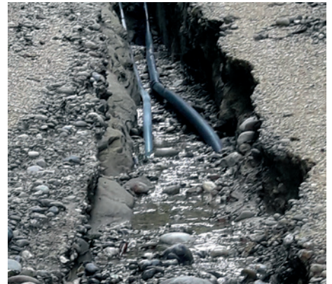
Aetingen: Freigespülte Wasser- und Stromleitung
