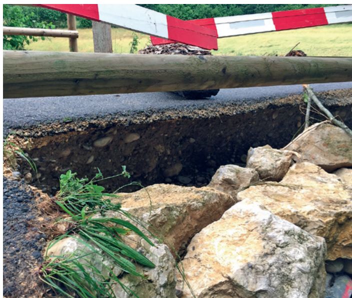
Brügglen: Schaden an Brücke/Bachdurchlass
